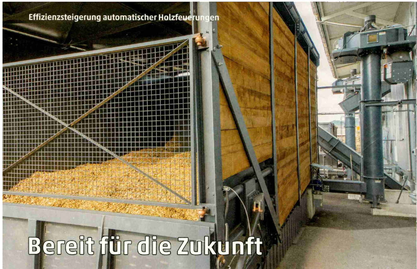
Bild oben: Wärmeverbund Eschlikon Brennstofflager.
