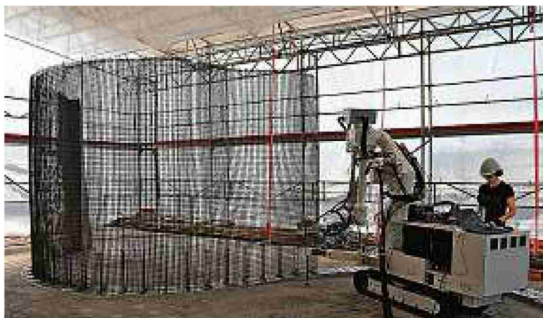
An der Arbeit: «In situ Fabricator»- Roboter zum Bauen mit der neuen «Mesh Mould»-Technik.
