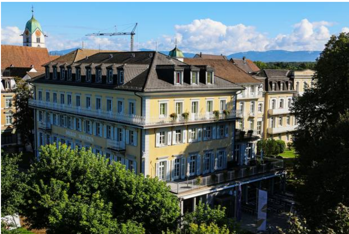
Rheinfelden, 25. Februar: Der «Schützen» wird derzeit umgebaut. Im April eröffnet das Restaurant wieder,
